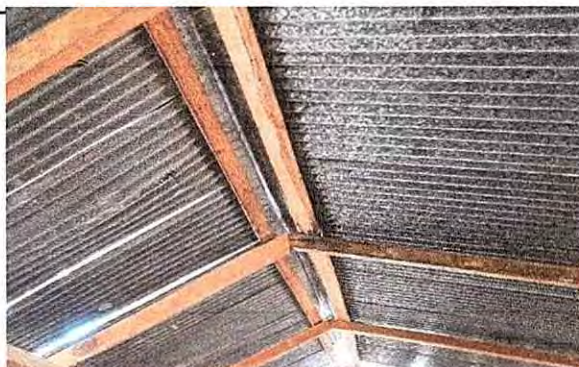
FOTO 6. Techo en mal estado, módulo 2.
