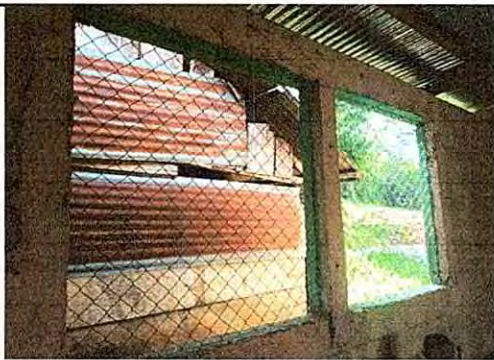
FOTO 5. Ventanales en mal estado, módulo 2.
