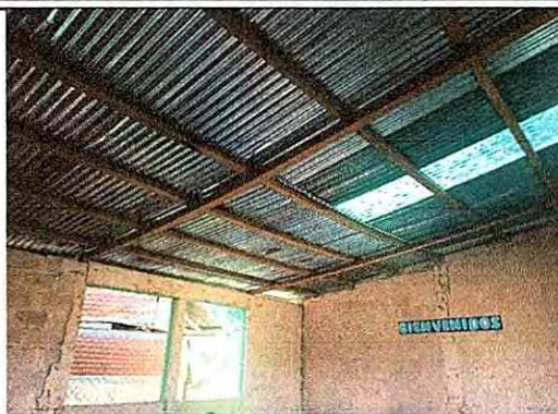
FOTO 2. Techo en mal estado, módulo 2.
