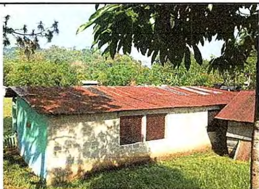
FOTO 3. Techo módulo 2 en mal estado
