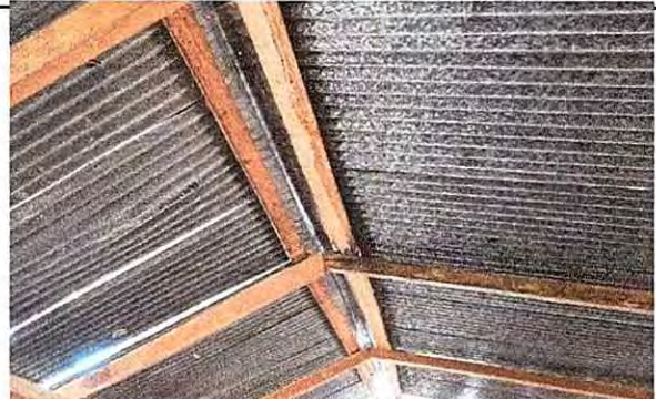
FOTO 6. Techo en mal estado, módulo 2.
