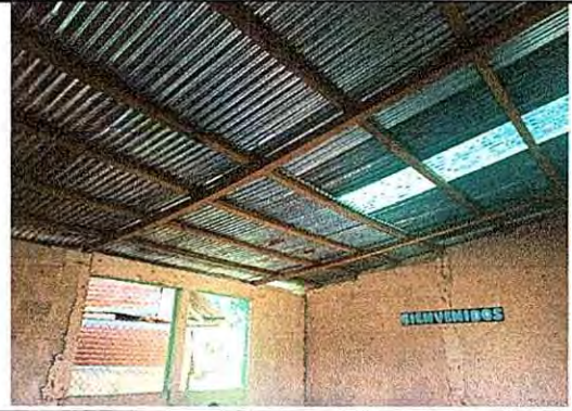
FOTO 2. Techo en mal estado, módulo 2.
