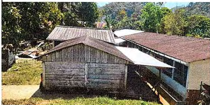
FOTO 1. Techo en mal estado .
