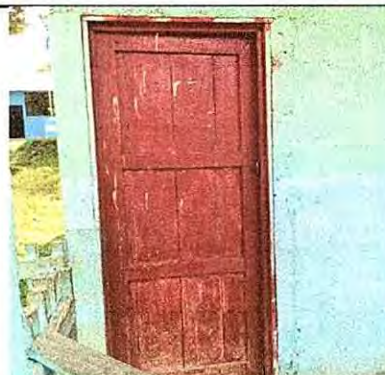
FOTO 4. Puerta 2, en mal estado, módulo 2.
