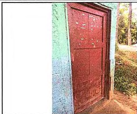
FOTO 1. Puerta 1, en mal estado, módulo 2.
