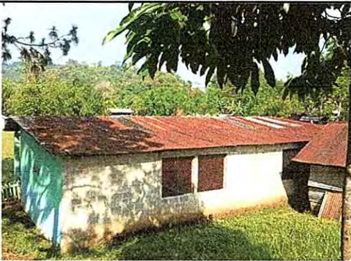
FOTO 3. Techo módulo 2 en mal estado
