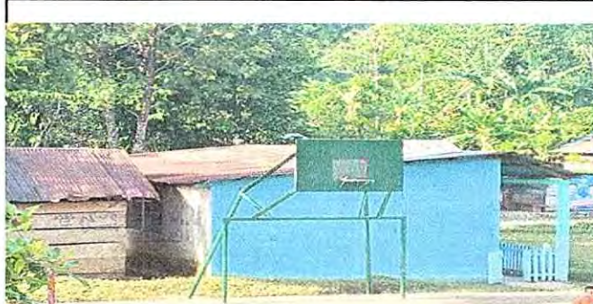
FOTO 6. Se muestra el estado de la pared
