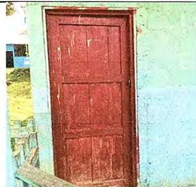
FOTO 4. Puerta 2, en mal estado, módulo 2.
