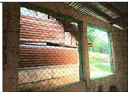
FOTO 5. Ventanales en mal estado, módulo 2.
